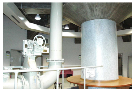
水槽を支える心柱と仕切弁 筆者撮影
