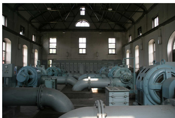
〔写真3〕第1ポンプ所のポンプ室、国産のみのくち式渦巻ポンプ採用の先駆けとなった。 2005/07/08 筆者撮影
