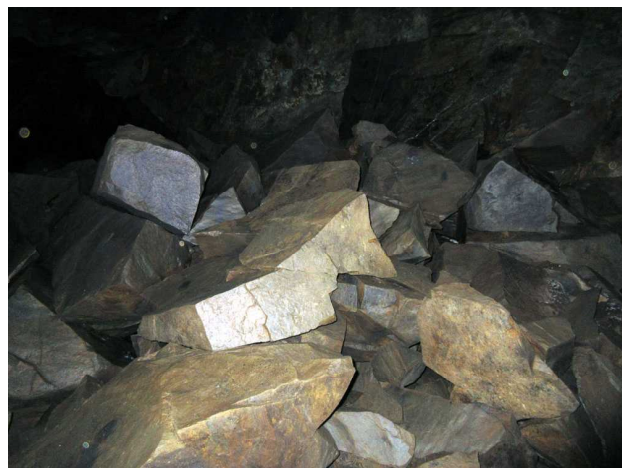
〔写真3〕 西壕内部(落石で埋め尽くされた床面)
