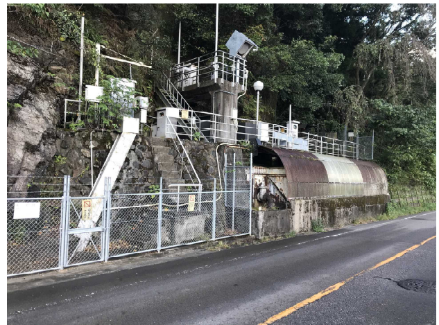
井ノ面発電所 (300kW) 写真：筆者撮影
