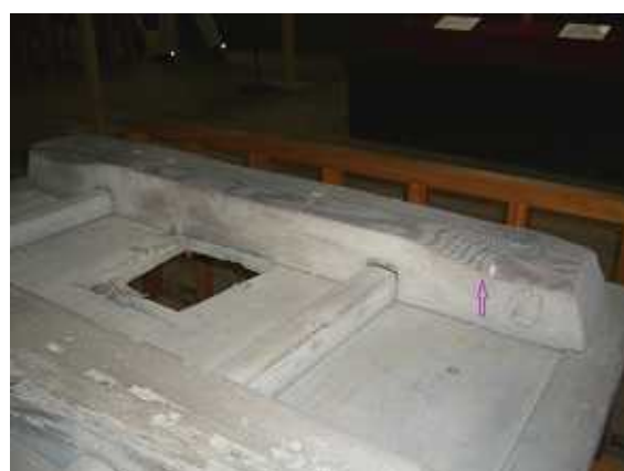
写真10 磨滅した踏板の部材
