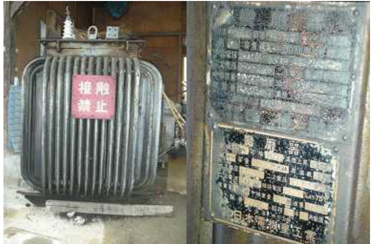
写真4 油入自冷式変圧器とその銘板（2枚） 2009年12月24日 筆者撮影
