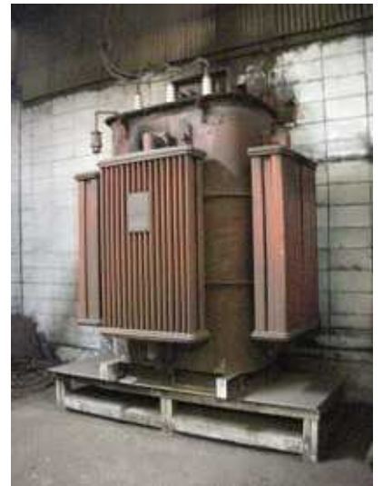
写真 15 予備の電気炉設備 2010年7月26日 筆者撮影
