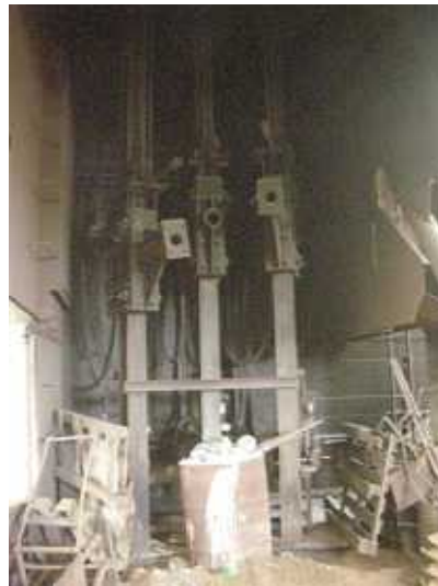
写真 14 3相変圧器 2010年7月26日 筆者撮影
